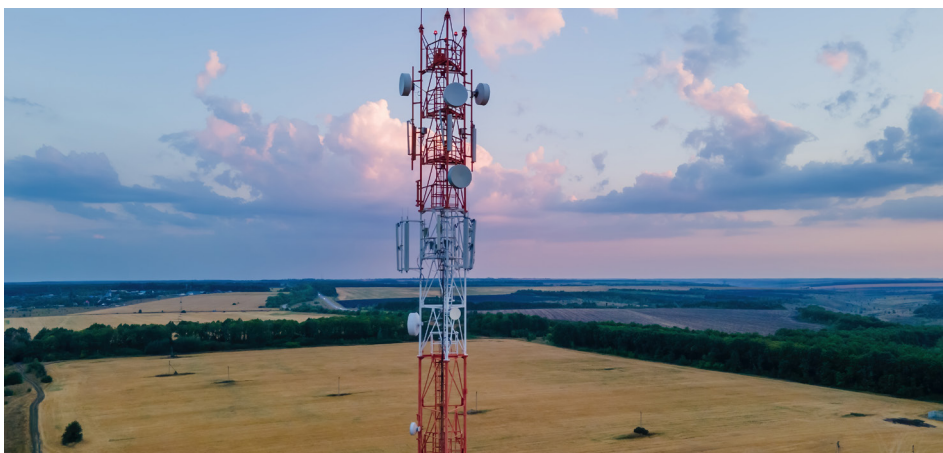
Beim Cell Broadcast werden Warnungen via Funkmasten direkt und zur gleichen Zeit auf alle Smartphones der Umgebung übertragen.
